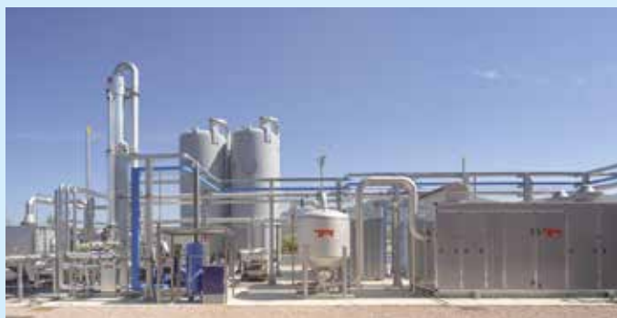
Impianto di upgrading HPSM a membrane in 3 stadi presso l'impianto Biometano di Snam 4 Environment (capitale 100% Snam S.p.A.)
